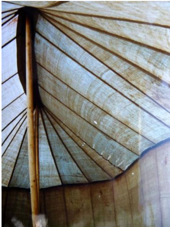
Abbildung 12: Innenseite des Daches. Die verstärkenden Gurte sind gut zu erkennen. Der Fadenverlauf der Keile folgt immer der Zugrichtung. In der geraden Bahn rechts sehen wir erste Zugrisse. Die Gurte fehlen natürlich bei der Seitenwand, weil diese nur wenig Zug aufnehmen müssen. Man bemerke, wie lichtdurchlässig das Leinen ist.
